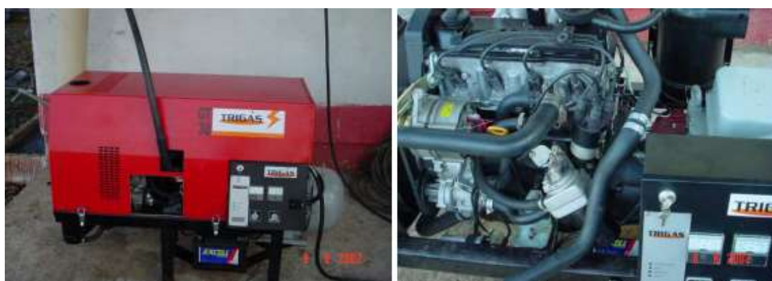
Figura 2- Grupo economizador/gerador de energia elétrica com uso de biogás.
